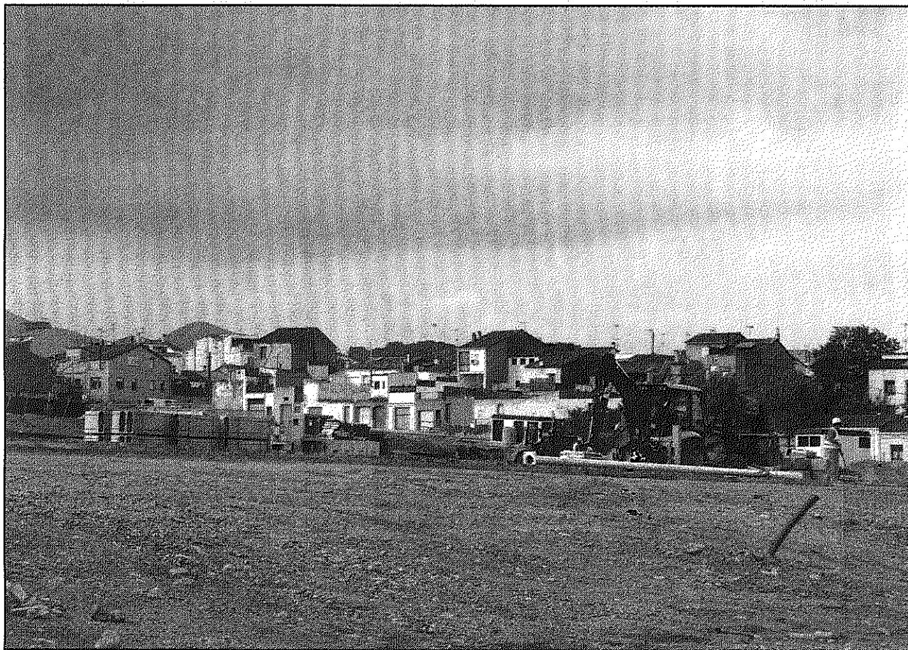
Una imatge dels treballs d'urbanització que s'estan fent als terrenys de l'antiga Forestal (A4BM)
