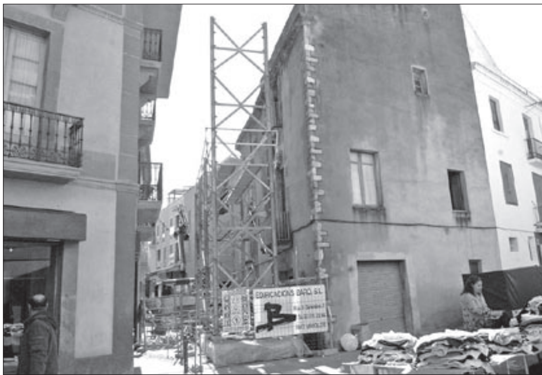
L'estructura metàl·lica subjectarà la façana i permetrà desenrunar la botiga on es va ensorrar el sostre el 2 de març
