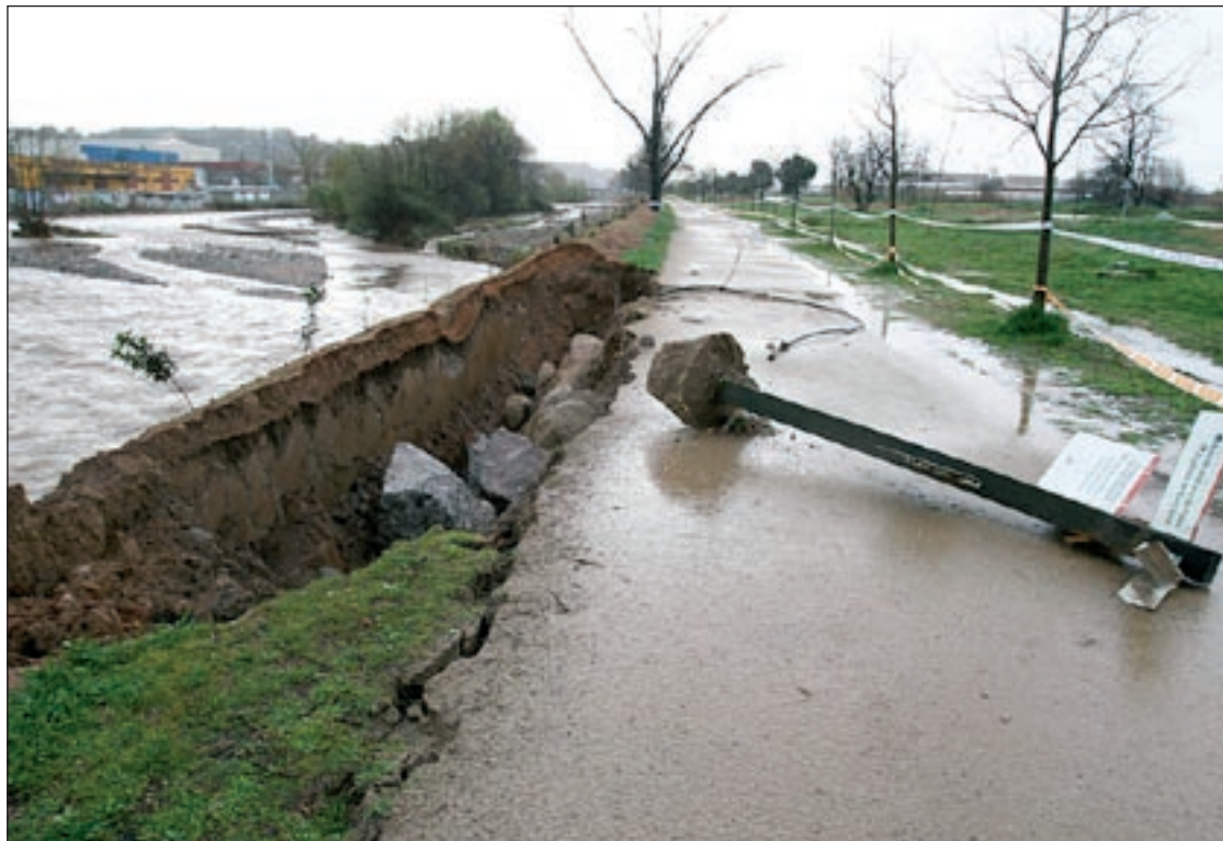
La força de l'aigua va descalçar un tram de la nova escullera vegetal i va malmetre el camí del costat del riu
