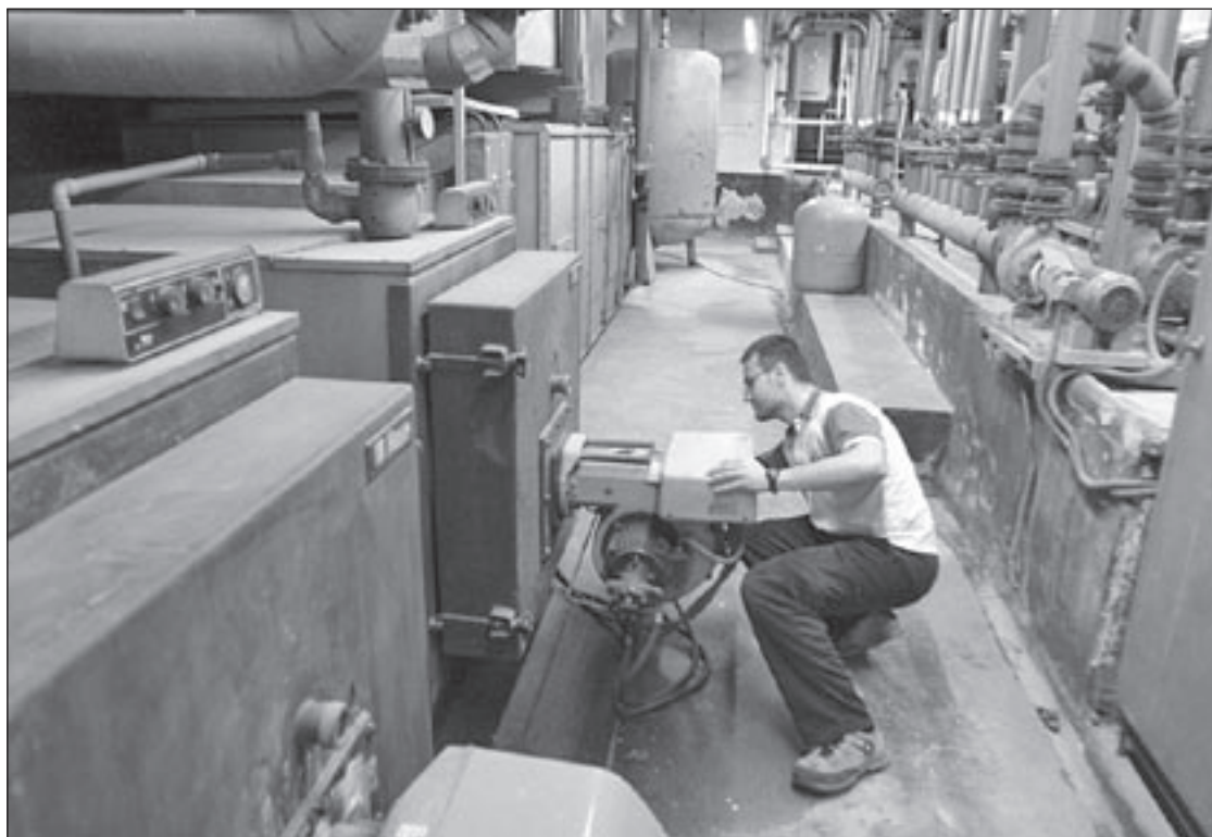
El tracte amb l'empresa de cogeneració inclou la renovació de la instal·lació primària, incloses les velles calderes de gasoil
