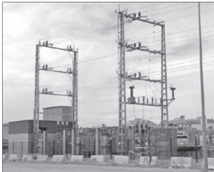
El ferit va escalar la tanca de la subestació i es va enfilat a una de les torres
