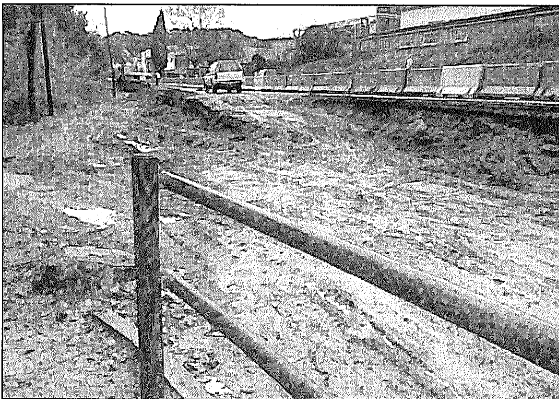
Una imatge del fangar que van ocasionar els aiguats a les obres del pas soterrat (JR)
