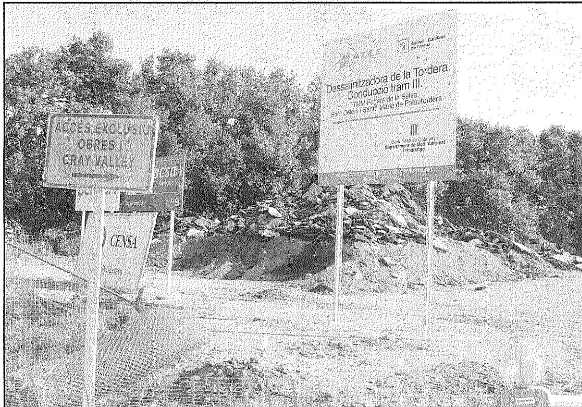
Una imatge dels treballs per instal·lar els conductes que portaran aigua dessalada de Blanes (L'AdBM)
