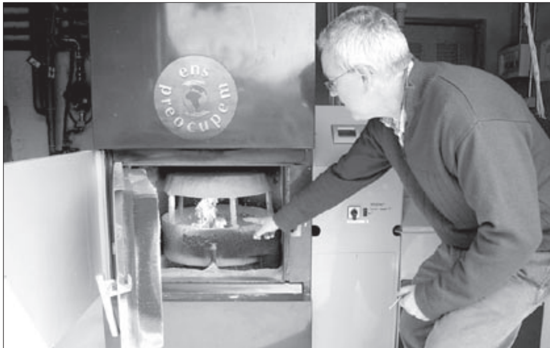
El regidor de Medi Ambient, Pere Vicente, mostra el cremador de la caldera de biomassa del pavelló municipal
