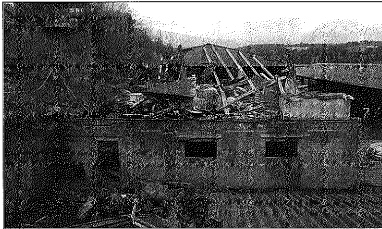
Vista general de la granja de Can Clavell después del temporal..
