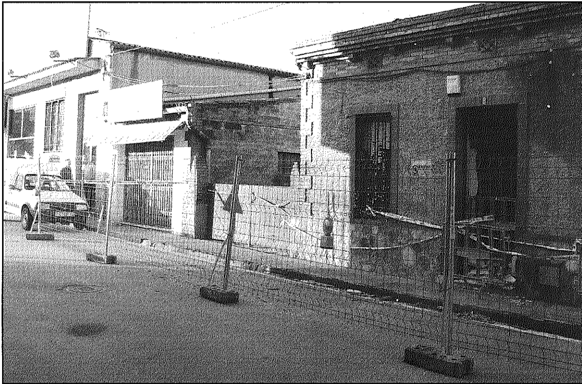
Els habitatges afectats s'han precintat i s'ha establert una protecció de seguretat (L'AdBM)
