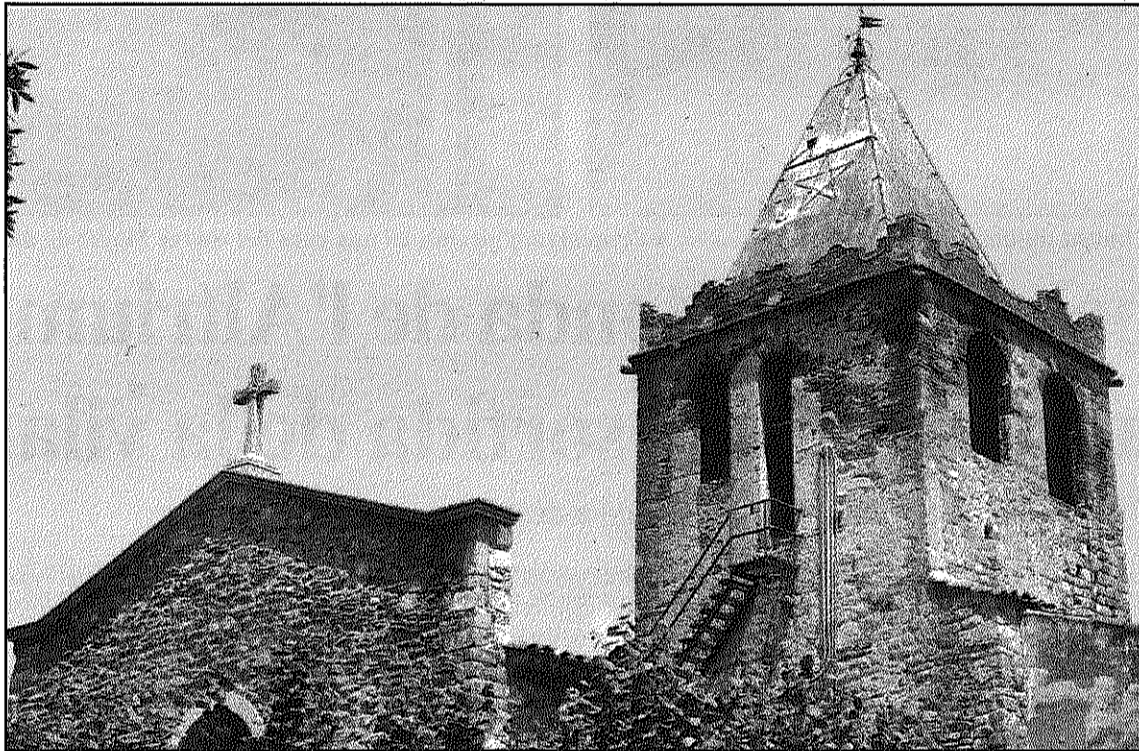
Els conductes que connecten l'antena a l'interior del campanar n'afecten la façana (L'AGBM)
