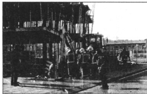
Bombers i tècnics treballen per controlar la fuga (L'AdBM)
