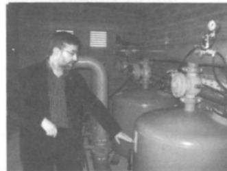
Planta de tractament de l'aigua extreta del canal d'aigües Ter-Llobregat
