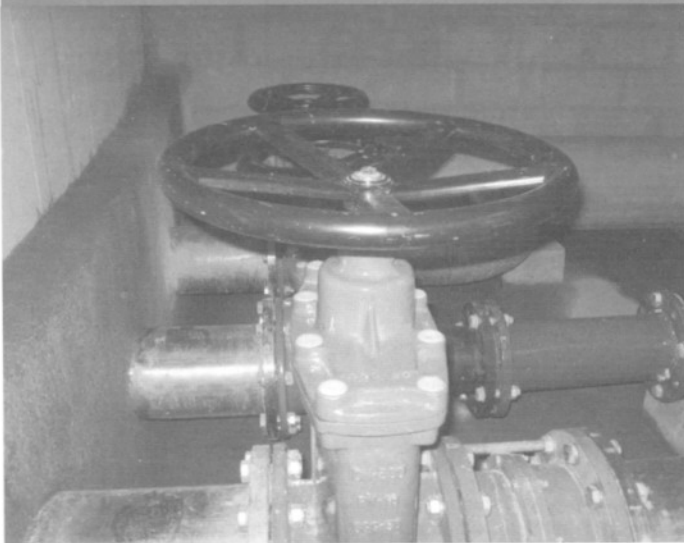
Les Claus i canonades del nou dipòsit del Turó
