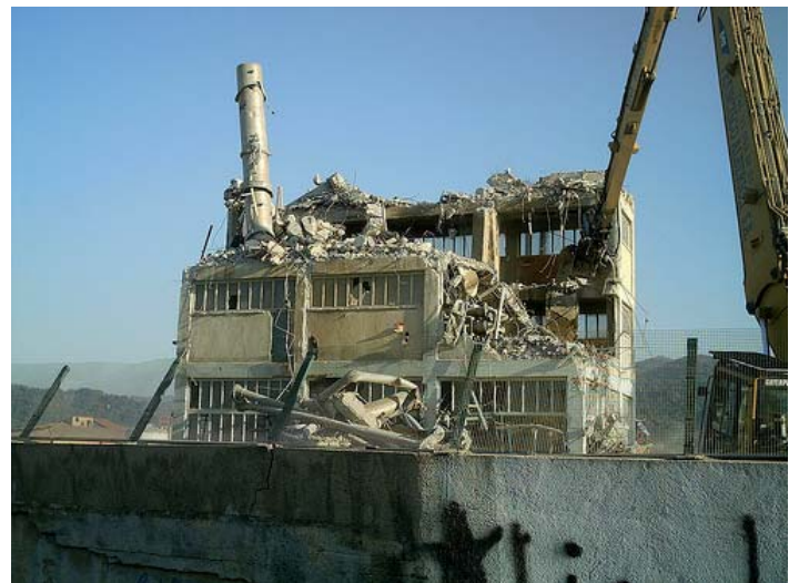
Moment que s'enderrocava la torre i xemeneia principal de Derivados Forestales, SA. L'alliberament dels 35.000 m2 del solar suposarà un canvi urbanístic substancial per Sant Celoni (Foto: P&P)
