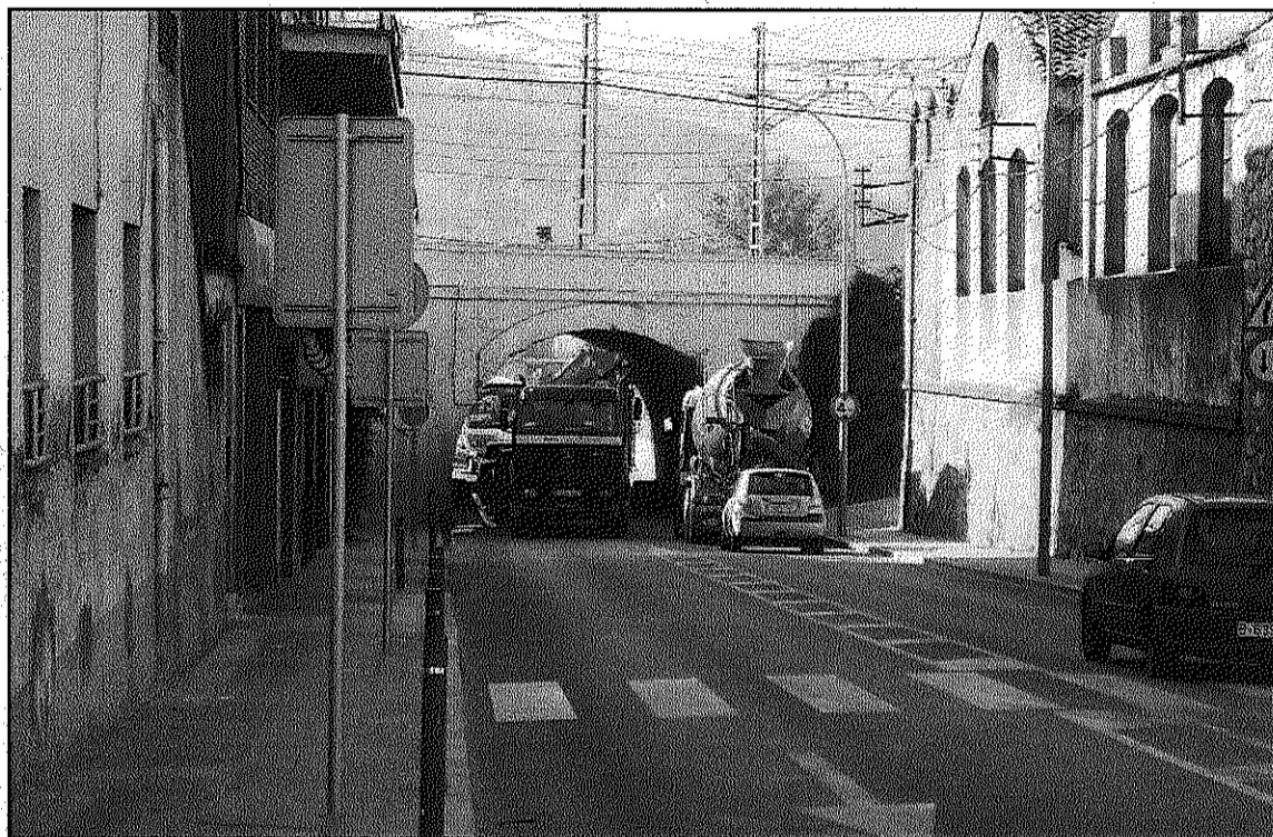
Les obres del túnel d'entrada van a un pas massa lent (L'AdBM)
