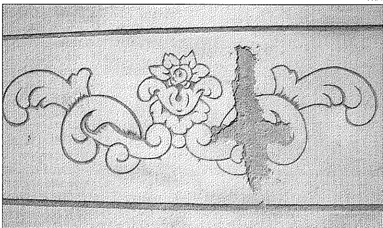
Los daños sobre los esgrafiados saltan a la vista.
