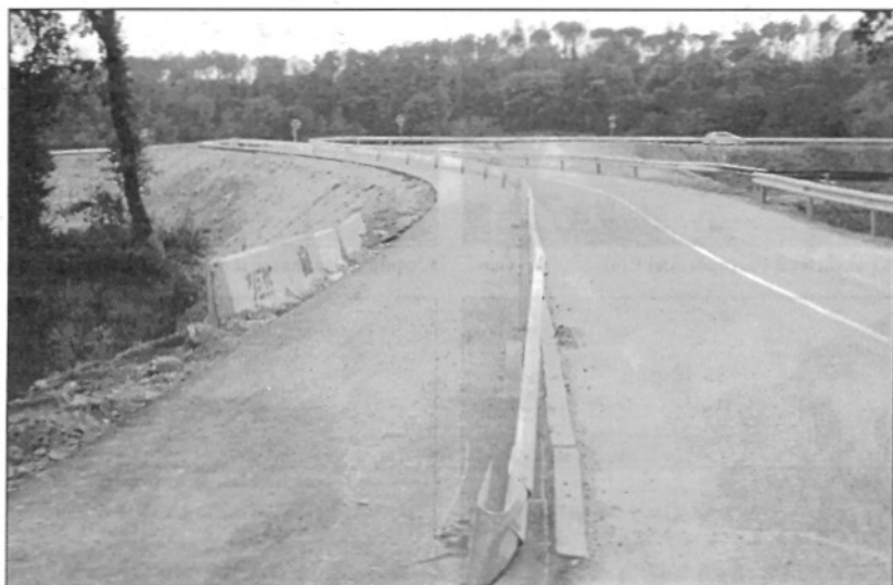
L'accés per carretera de l'IES és perillós i no permet el gir correcte dels autocars (L'ADIF)
