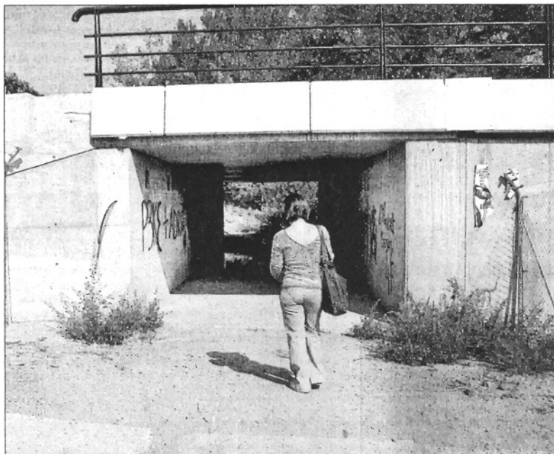
Els accessos a l'IES Baix Montseny presenten un fort deteriorament, motivat, en part, per les obres del TAV
