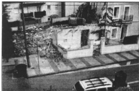
Enderroc sense cap tanca de protecció (L'ABM)
