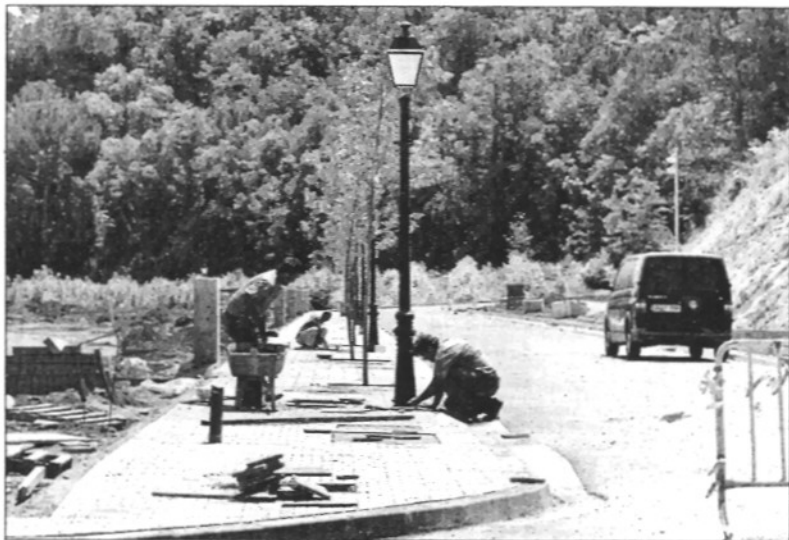
Les obres al carrer contribuiran a millorar els fluxos de trànsit al nucli de Gualba
