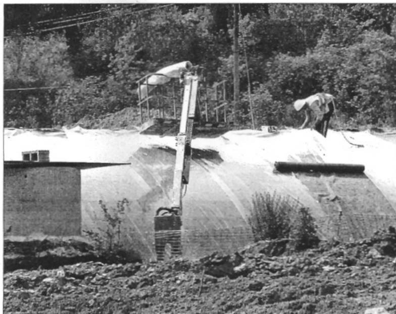
Els treballs de construcció del TAV avancen a la zona del Baix Montseny, com es veu en aquesta imatge a Sant Celoni
